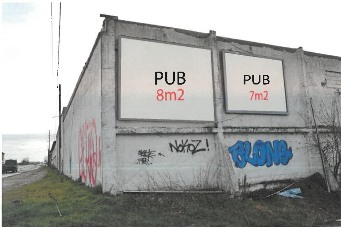
Etat actuel (panneaux de 7,5m 2 et 7m 2 ) puis projection de panneaux de publicité de 8m 2 , D606 en ZP3.
